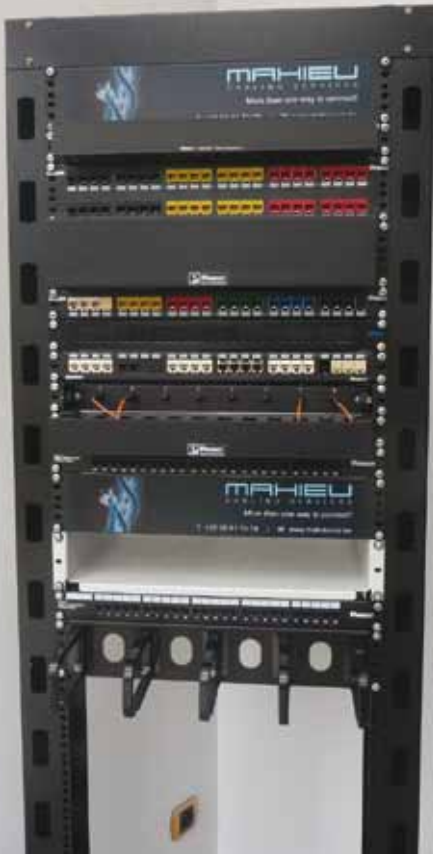
Netwerkbekabeling vereist een voorzichtige, nauwkeurige manier van werken. Zogenaamde 'details' zijn uiterst belangrijk, zeker voor wat betreft glasvezelbekabeling.
